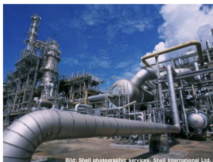
GTL-Produktionsanlage Bintulu, Malaysia
